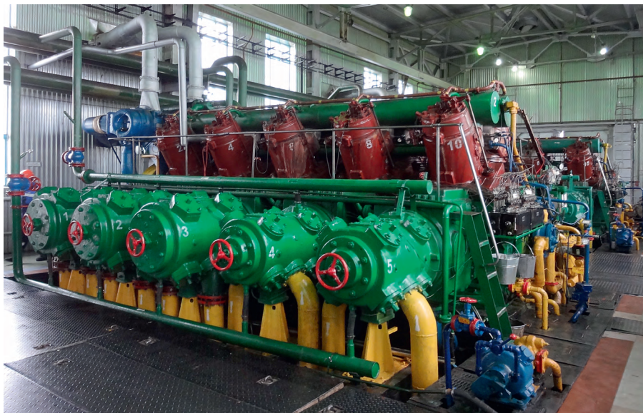
Рис. 1. Газомотокомпрессор типа 10 ГКН
