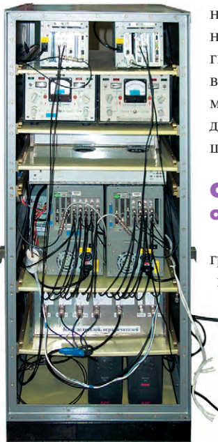
Рис. 2. Приборная стойка с оборудованием измерительного комплекса
