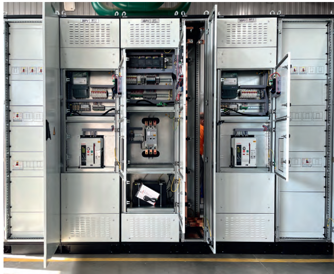
Рис. 2. Система АВР на базе оборудования Митра (Mitra): элементы системы АВР внутри шкафа
