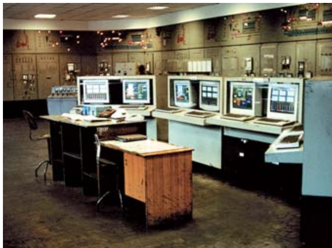
Рис. 5. Операторская цеха № 1 НКТУ: рабочие станции попарно (основная и резервная) размещены в пультах с принудительным нагнетанием чистого воздуха для защиты от сажевой пыли
