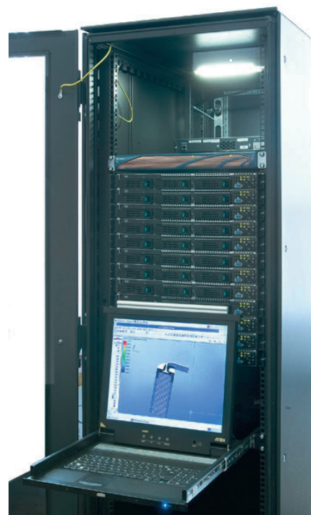
Рис. 1. Шкаф мультипроцессорной системы
