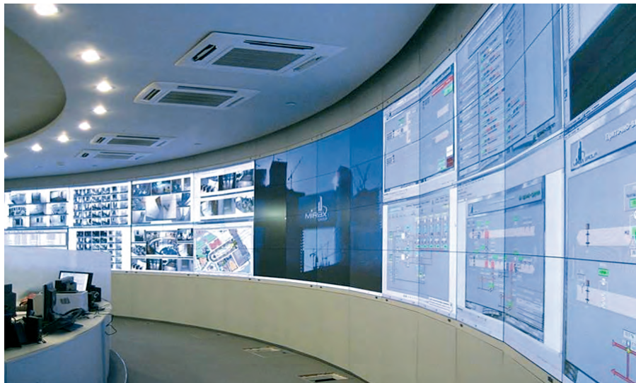
Рис. 7. Центр диспетчерского управления башен «Федерация»
