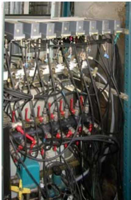
Рис. 4. Шкаф с преобразователями ЭПП и ПЭП
