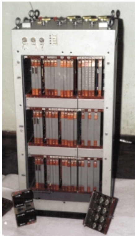
Рис. 4. Шкаф аппаратуры МСУД
