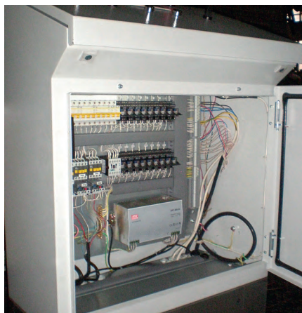
Рис. 4. Электрооборудование системы, установленное на монтажной панели пульта
