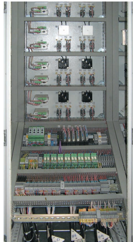
Рис. 4. Секция контроля и управления электродвигателями
