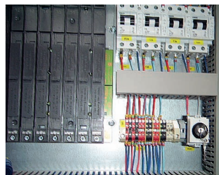
Рис. 7. Шкаф AD-D: установка автоматов защиты
