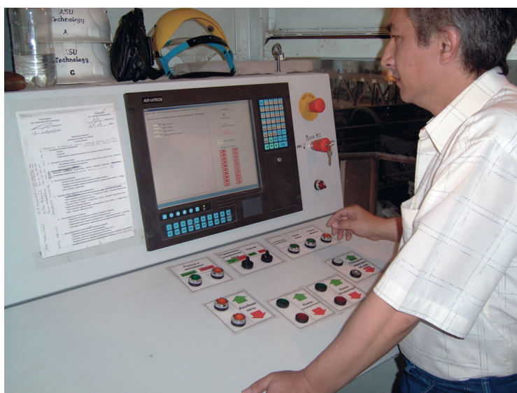
Рис. 9. АРМ оператора с пультом управления и рабочей станцией
