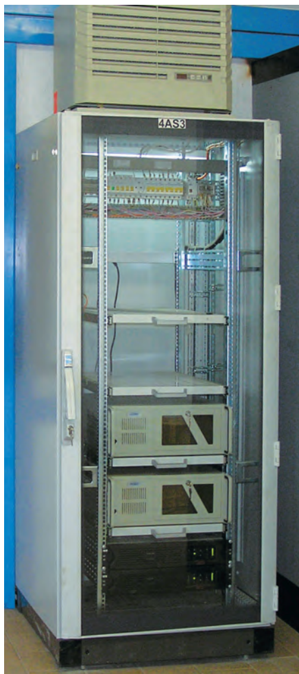
Рис. 4. Шкаф Rittal с промышленными компьютерами
