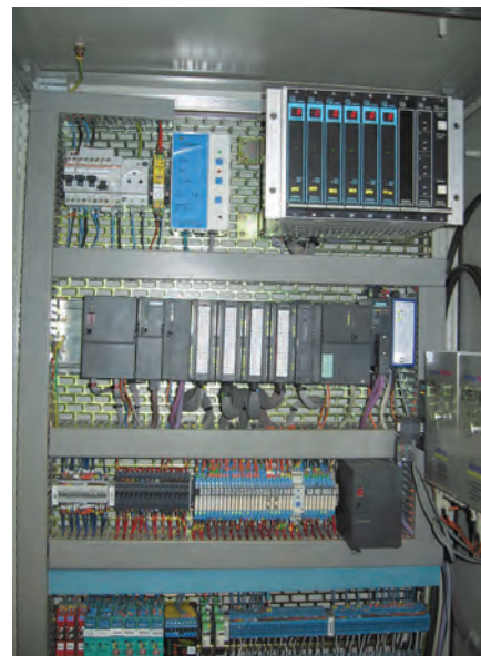
Рис. 4. Шкаф центрального контроллера А3
