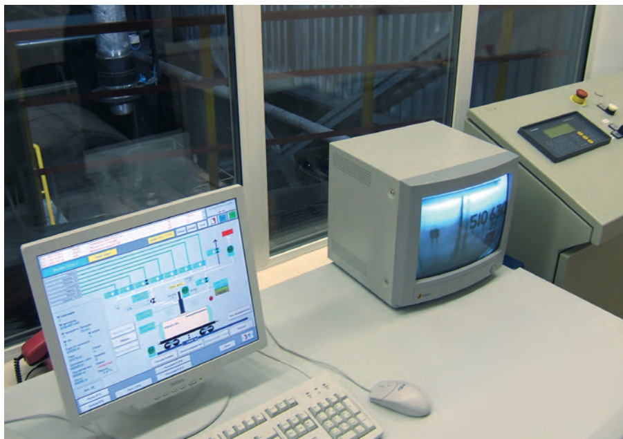
Рис. 5. Оборудование АРМ оператора
