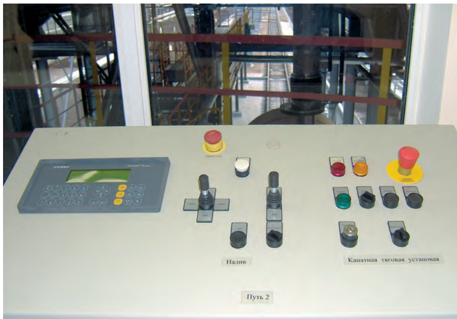
Рис. 7. Пульт управления наливной трубой и системой тяги вагонов
