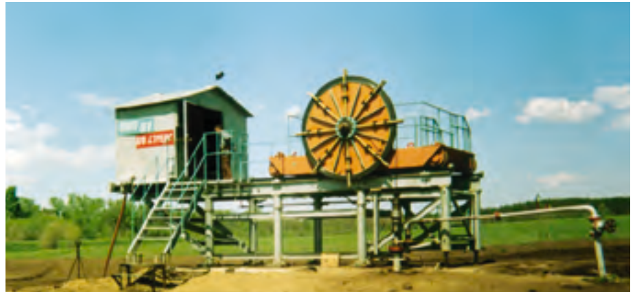
Рис. 2. Общий вид длинноходовой насосной установки
