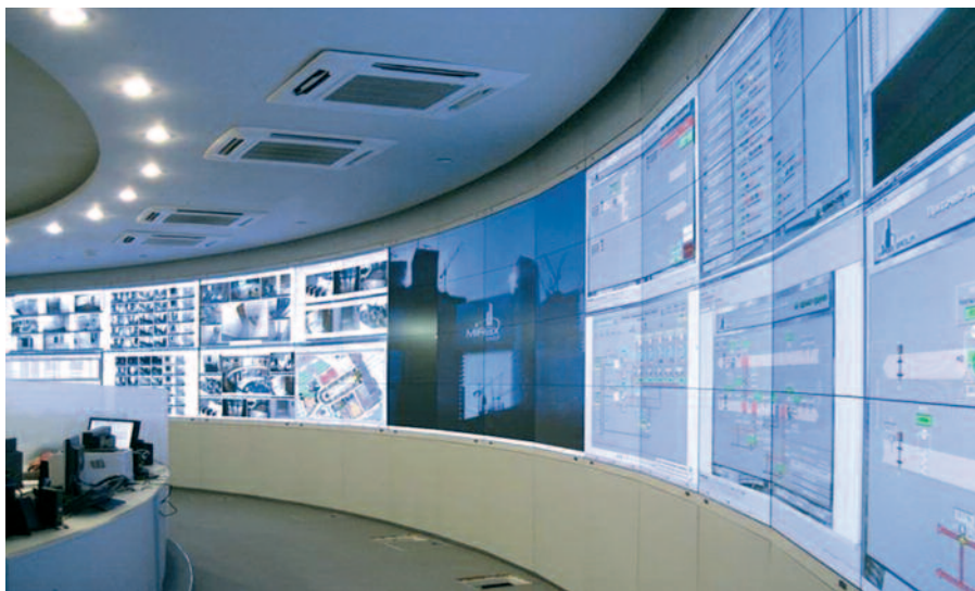
Рис. 7. Центр диспетчерского управления башен «Федерация»
