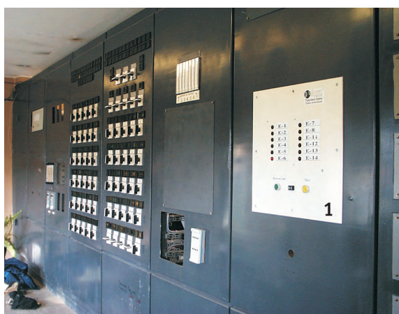
Рис. 10. Панель индикации (1) системы аварийной сигнализации
