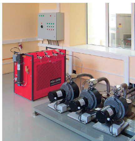
Рис. 4. Пульт силовой, компрессор и вакуумные насосы установки калибровки
