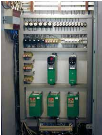
Рис. 2. Силовой шкаф управления экструзионной линией на базе частотных регуляторов UniDrive и SE-Commander
