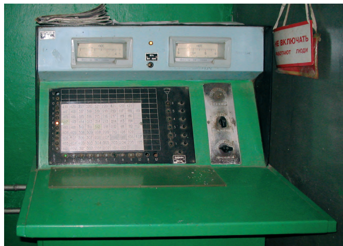
Рис. 2. Пульт управления устаревшей системы ДКТЭ-4М
