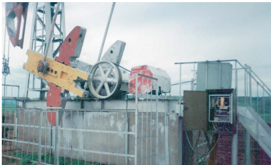
Рис. 4. Металлический контейнер с типовым контроллером, установленный на станке-качалке
