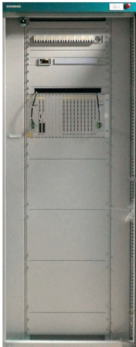
Рис. 6. Шкаф визуализации с контроллером SICAM AK 1703 АСР системы АСУЭ ЛК-2Б
