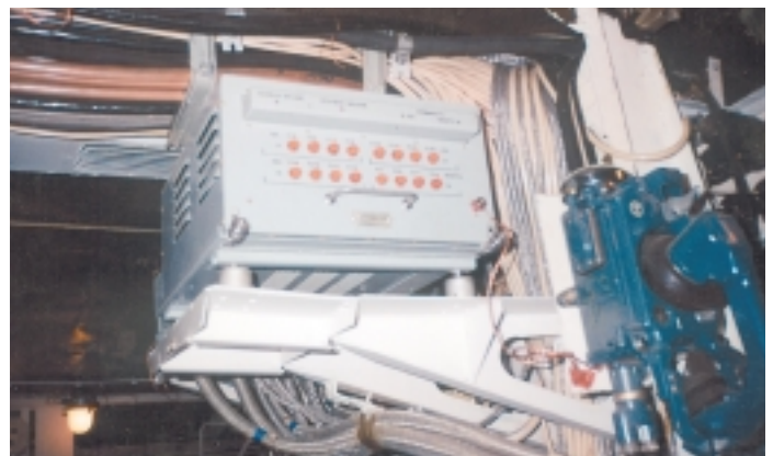
Рис. 6. Машинное отделение. Блок аварийно-предупредительной сигнализации и защиты (АПСиЗ)
