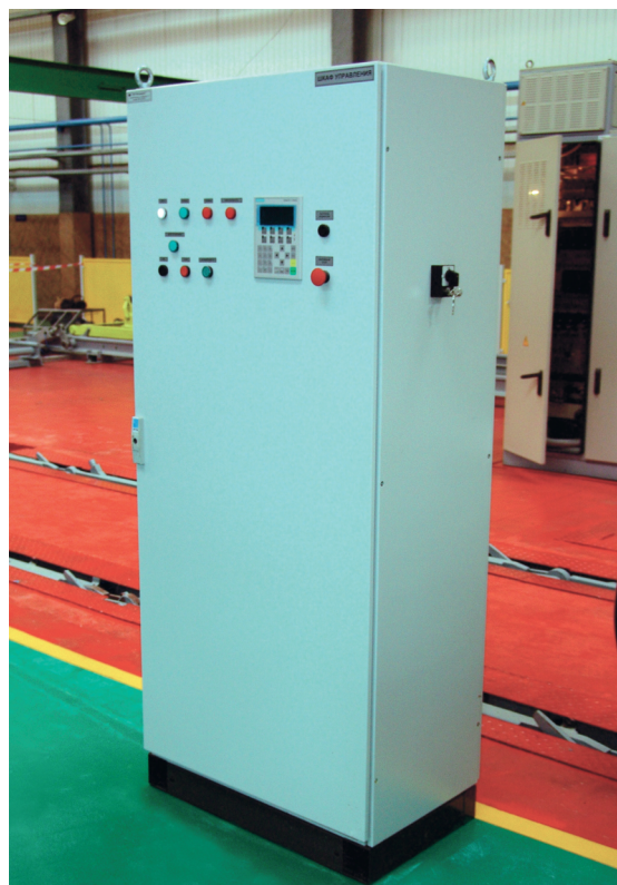
Рис. 6. Щитовое электрооборудование подсистемы № 11
