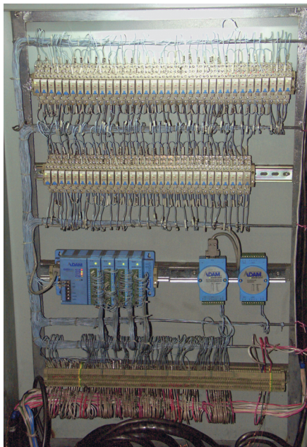
Рис. 5. Общий вид шкафа контроллера смесильной машины
