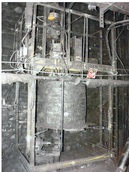
Рис. 1. Общий вид реконструированного дозирочного модуля
