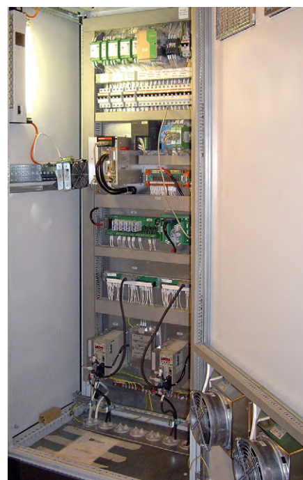
Рис. 6. Щит системы управления
