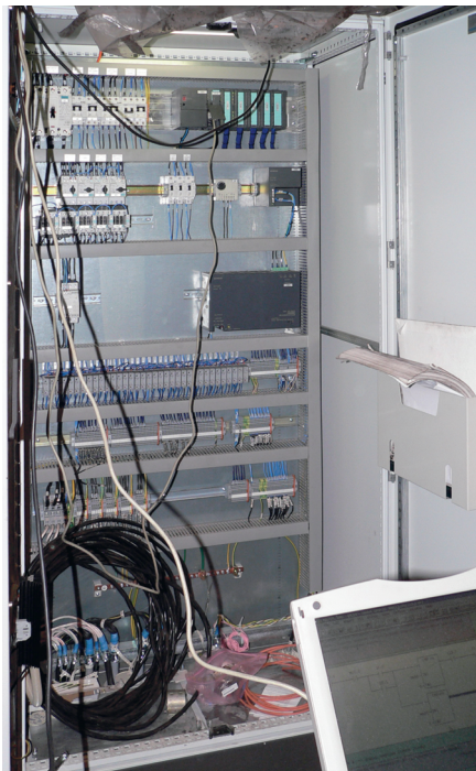
Рис. 4. Общий вид шкафа управления станком
