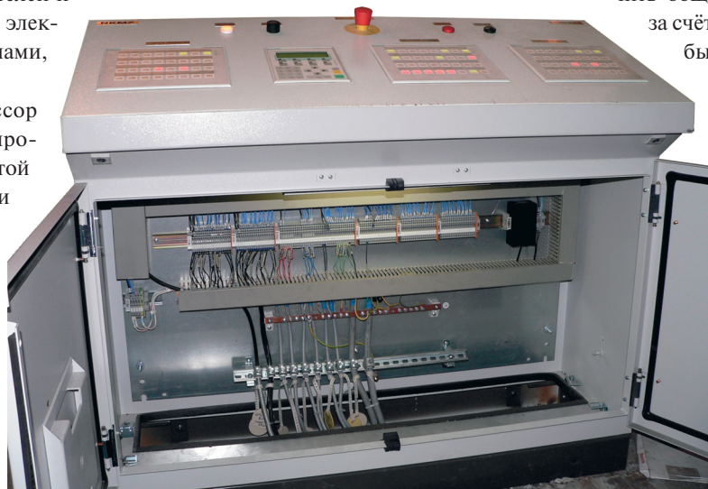
Рис. 5. Пульт управления стандом сборки-разборки опорных и рабочих валков
