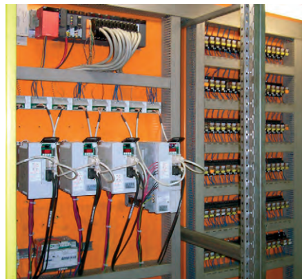
Шкаф управления АПЛ
