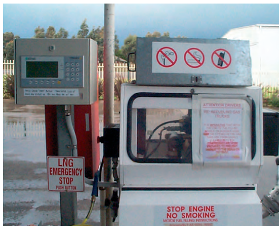
Панель TERMEX в составе оборудования газозаправочной станции
