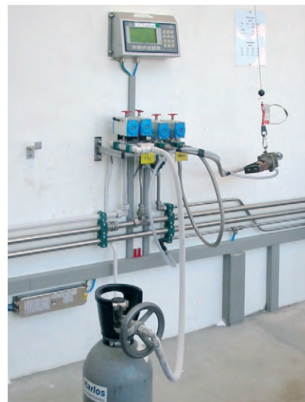
Применение TERMEX для проверки и взвешивания газовых баллонов
