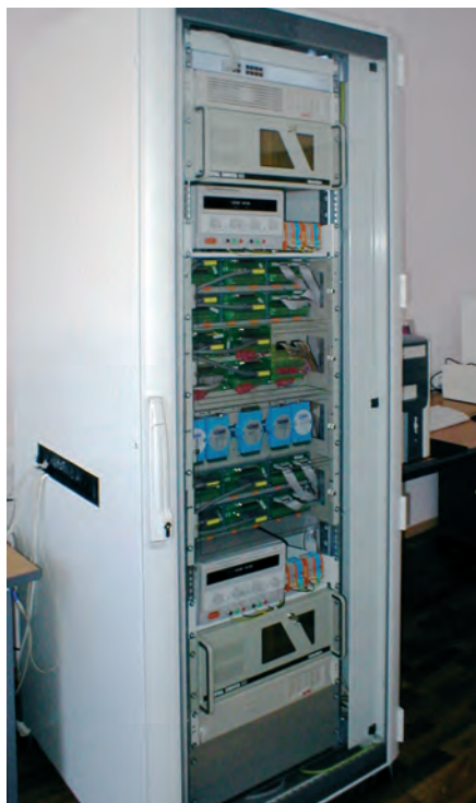
Рис. 2. Шкаф с устройствами комплекса
