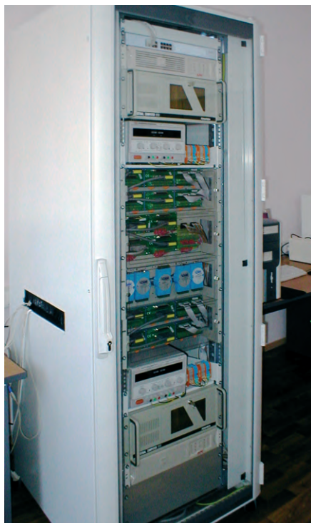
Рис. 2. Шкаф с устройствами комплекса
