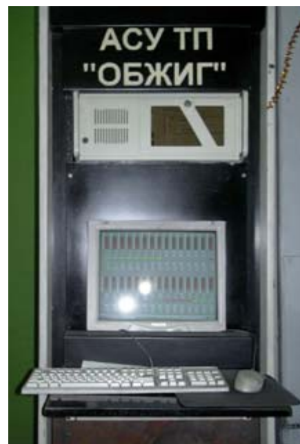
Рис. 4. Стойка управления обжиговой печи
