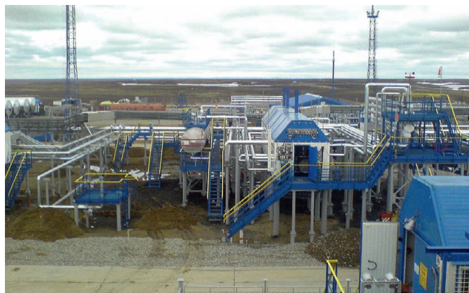
Рис. 3. Блок подготовки газа (по центру, в блок-боксе)
