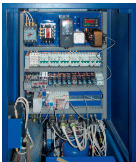
Рис. 3. Шкаф с оборудованием информационно-измерительной системы
