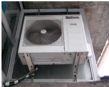
Рис. 3. Вид на наружный блок современной сплит-системы кондиционирования воздуха, установленной на лоджии
