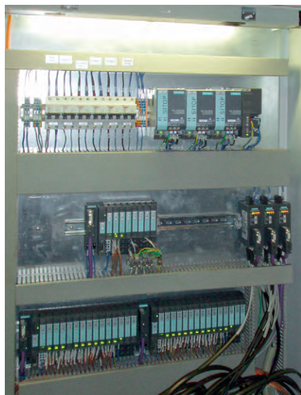
Рис. 4. Шкаф управления первичным и вторичным контурами охлаждения МНЛЗ
