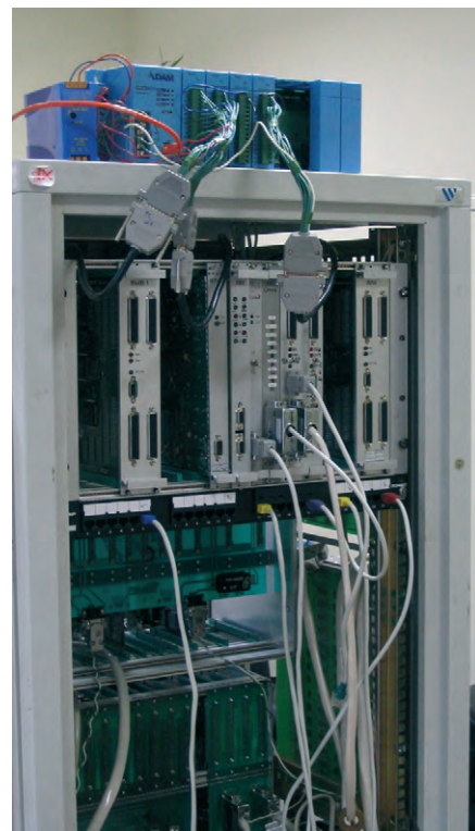
Рис. 2. Подключение микроконтроллера АДК к проверяемому оборудованию КП
