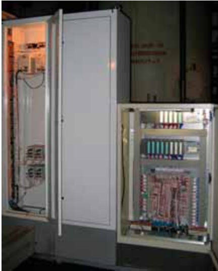
Рис. 3. Шкафы контроллера и вторичных приборов блока фильтров
