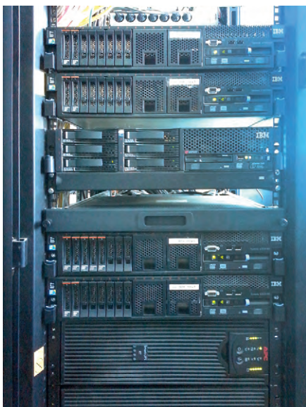
Рис. 4. Серверный шкаф рудника
