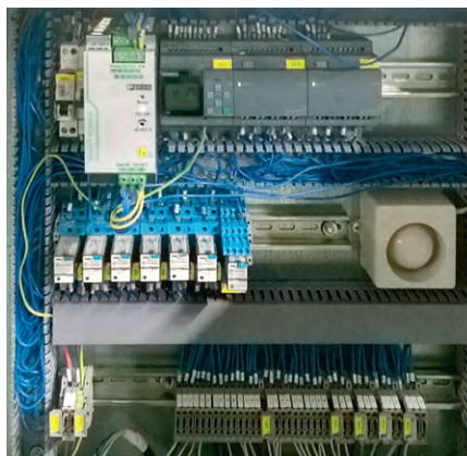
Рис. 3. Электрооборудование системы, установленное на монтажной панели пульта
