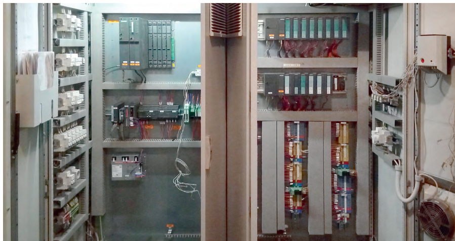
Рис. 4. Шкаф с основным контроллером и контроллером защиты
