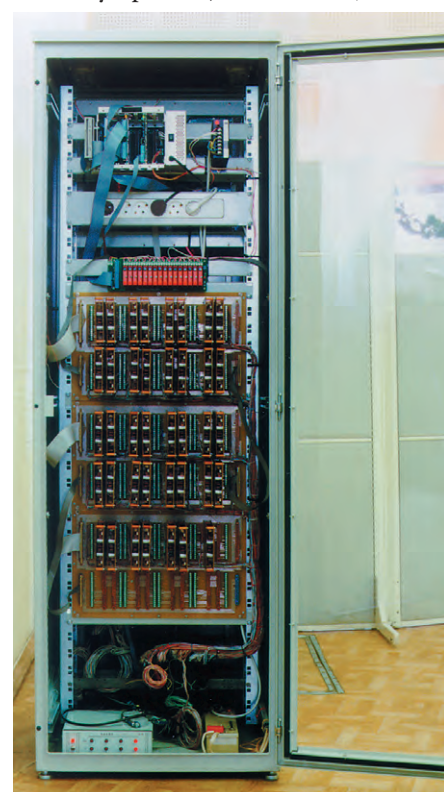
Стойка для подключения к станционным устройствам автоматики
