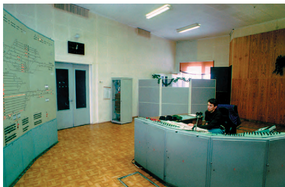
Размещение аппаратуры в помещении дежурного по станции
