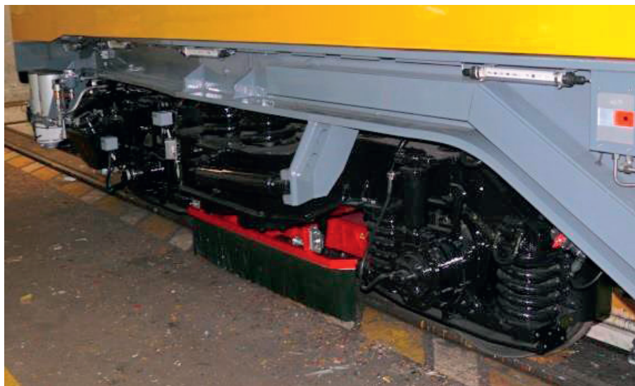
Рис. 3. Российская система контроля и диагностики МИБИС на колёсной паре локомотива DB (немецкие железные дороги)
