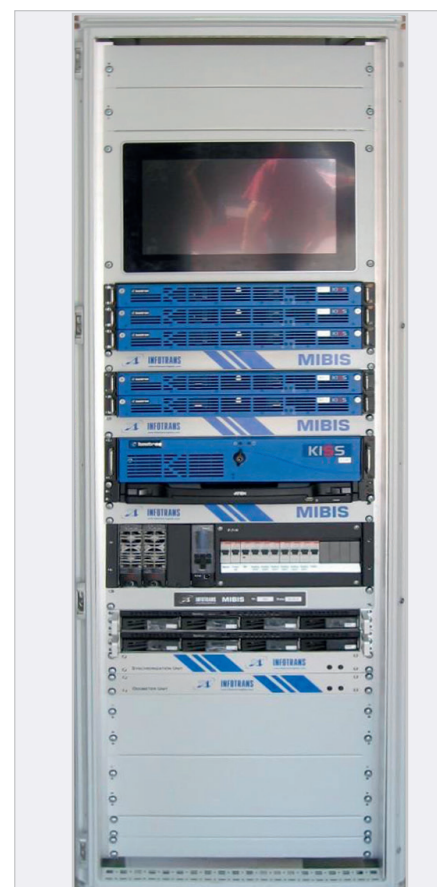
Рис. 4. Шкаф с модулями МИБИС и контроллером Wago серии 750
