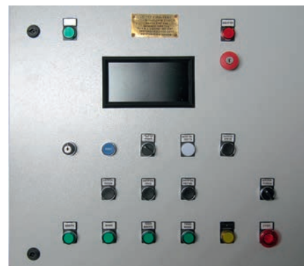
Рис. 4. Внешний вид станции сигнализации горизонта
