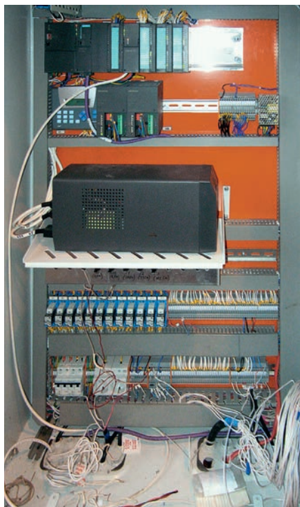
Рис. 1. Станция сигнализации машинного отделения
