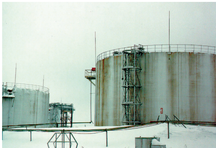
Рис. 1. Общий вид резервуарного парка
