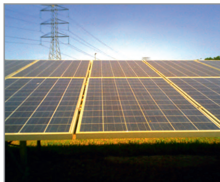
Рис. 1. Фотоэлектрические панели солнечной электростанции
