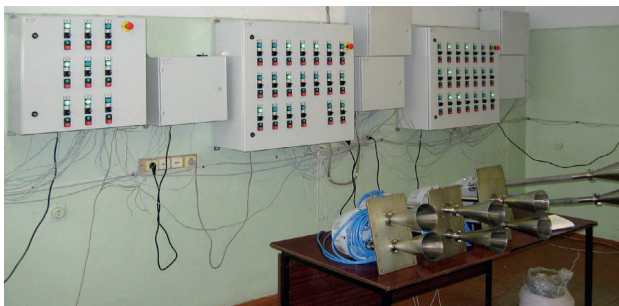
Рис. 3. Шкафы управления на этапе проведения испытаний
