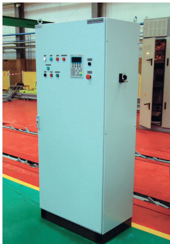
Рис. 6. Щитовое электрооборудование подсистемы № 11
