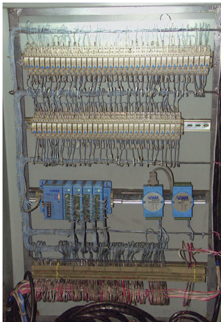
Рис. 5. Общий вид шкафа контроллера смесильной машины
