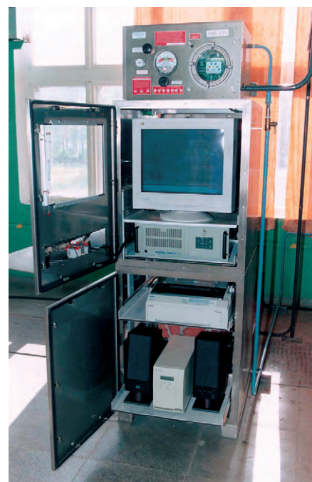
Рис. 5. Размещение вычислительного оборудования во взрывозащитном шкафу
