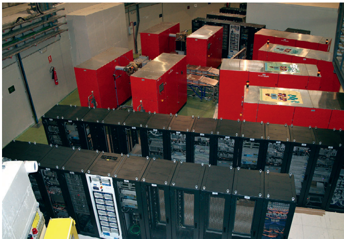
Рис. 3. Несколько сотен шкафов Varistar вмещают основное оборудование контроля и управления
