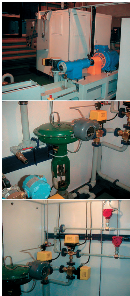
Рис. 2. Оборудование измерительного блока
