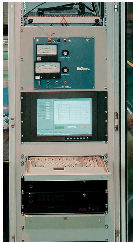
Рис. 10. АРМ оператора станда тестирования погружного электродвигателя
