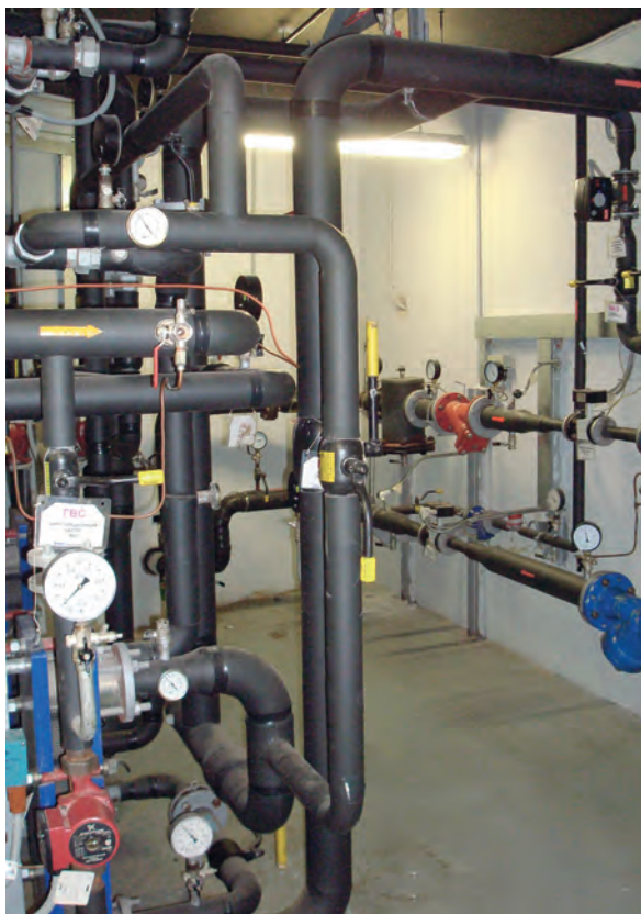
Рис. 5. Индивидуальный тепловой пункт
