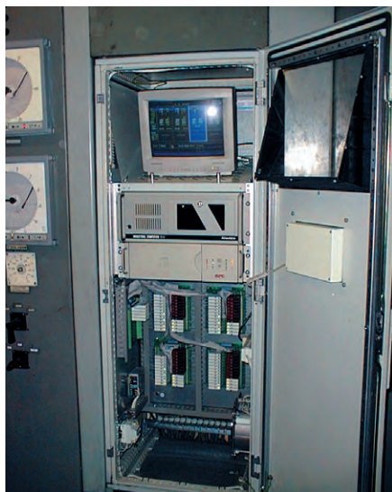
Рис. 4. Вид шкафа с открытой дверью спереди
